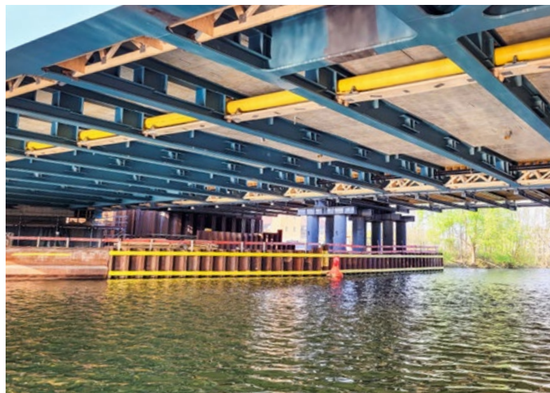
^ Unter der neuen Stabbogenbrücke verlaufende Gasleitung HD-VL DN 300 St
