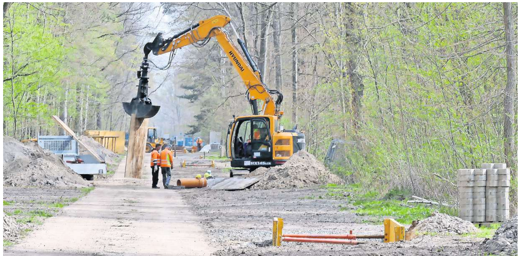
Eine der beiden jeweils 1,6 Kilometer langen Brunnengalerien, die sich durch den Naunhofer Forst zieht: Hier wird eine neue Leitung verlegt, an die die modernen Brunnen angeschlossen werden..
